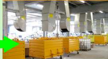
Silos de réception des fractions
